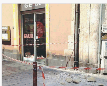
Crolla il pezzo di cornicione caduto in corso Tacito
